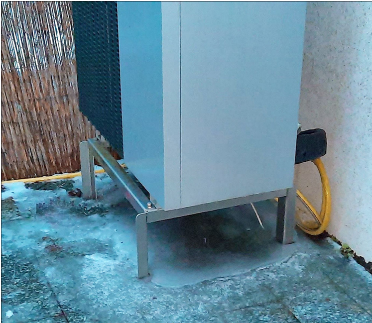
Abbildung 2.9 Vereister Boden rund um eine Luftwärmepumpe
