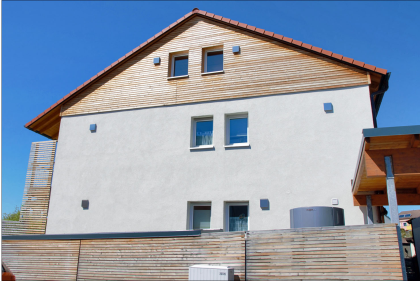
Abbildung 6.13 Die quadratischen Luftauslässe und -zulüsse ermöglichen eine Wohnraum- belüftung mit Wärmerückgewinnung.
