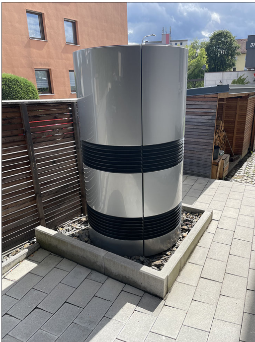
Abbildung 6.15 Die Luftwärmepumpe wurde straßenseitig platziert.
