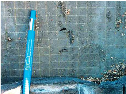
Abb. 1.1-28: Wasser sammelt sich über der Traufbohle und dringt durch Löcher in der Unterspannbahn ein.
