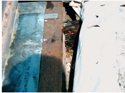
Abb. 1.1-32: Wassereintritt und verfaultes Holzwerk an der Traufe.
