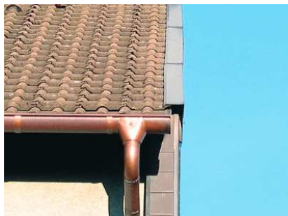
Abb. 1.1-33: Neue Rinne am Altdach.
