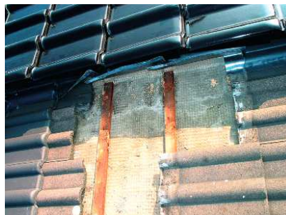
Abb. 1.1-26: Wassereintritt: Wasserspuren auf Unterspannbahn und in Kopfüberdeckungen der Dachsteine.
