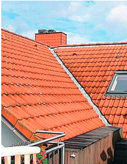
Abb. 1.1-24: Wasserschaden am Dremmel, auf den ersten Blick ist die Ursache nicht zu erkennen.
