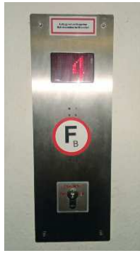
Abb. 4.8: Anzeigeta- bleau eines Aufzuges mit verlängerter Betriebszeit
