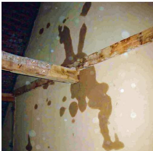
Abb. 5.6: Fehlender Schlagregenschutz führt zur partiellen Aufweitung von Wärmedämmlehm im Bereich von Deckenbalkendurchdringungen (Quelle: Stadt Buchen)
